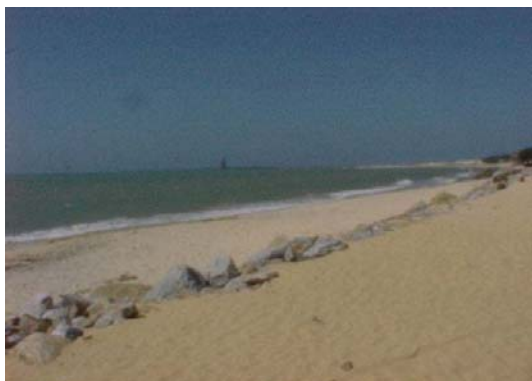
Figura AVP 69. Praia do Pecém. Detalhe do muro de contenção. Ao fundo o Porto do Pecém
