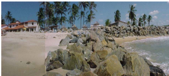
Figura AVP 70. Praia do Pecém. Detalhe da praia do lado de um dos espigões, evidenciando o processo de erosão (retirada de sedimentos)
