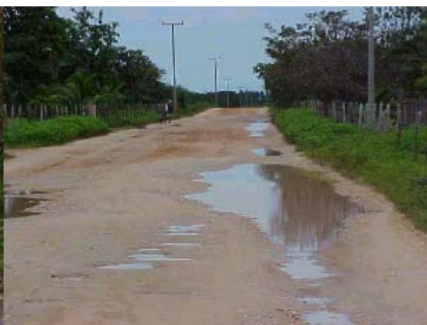
Figura TRA 17. Trecho em condições precárias, com muitos buracos e pontos de alagamento
