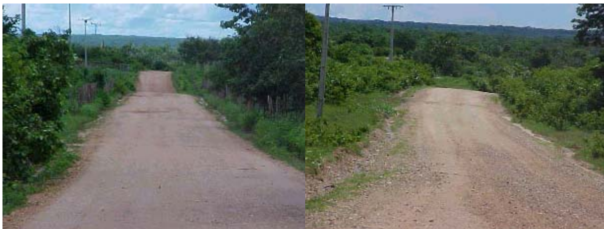
Figura TRA 06. Estrada precária, muitos pontos com buracos
