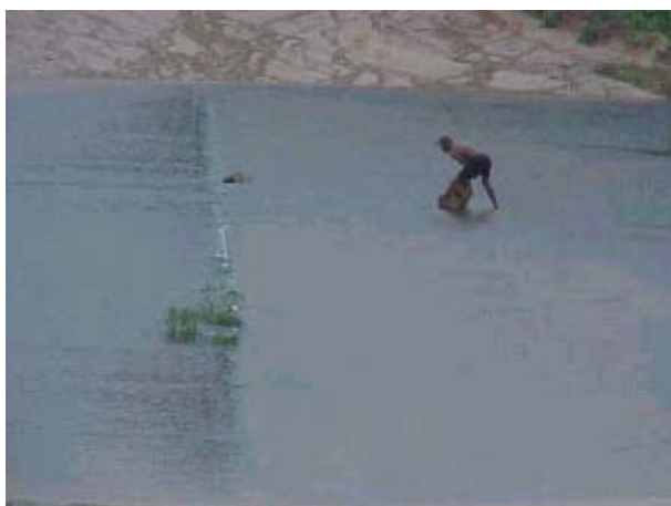
Figura TRA 08. Falta balizador de orientação nas passagens molhadas, tornando a travessia perigosa
