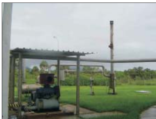
Foto 19 – Vista de um Queimador de Biogás Coletado no Reator UASB
