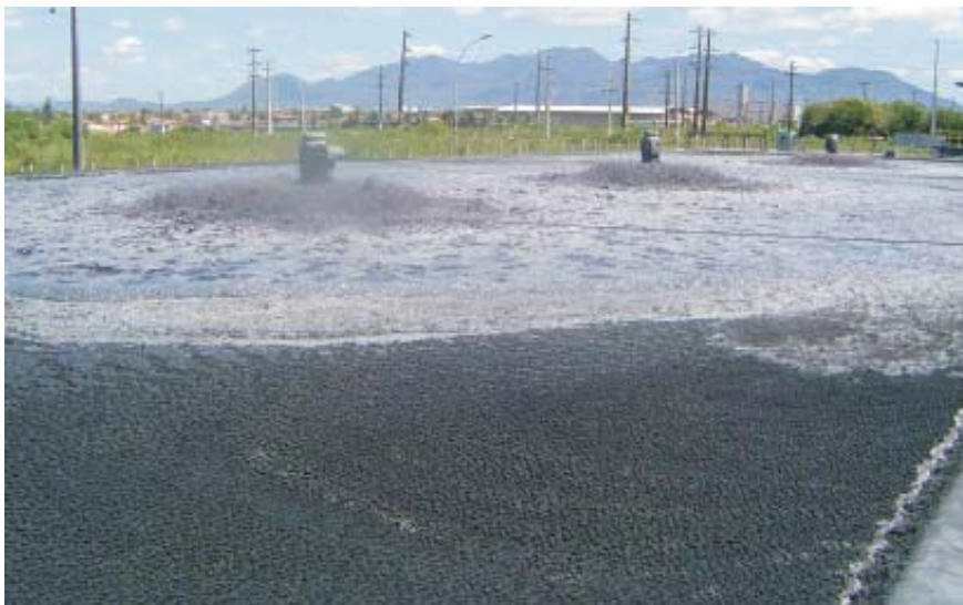
Foto 13 – Vista de um Tanque de Aeração de um Sistema de Lodos Ativos
