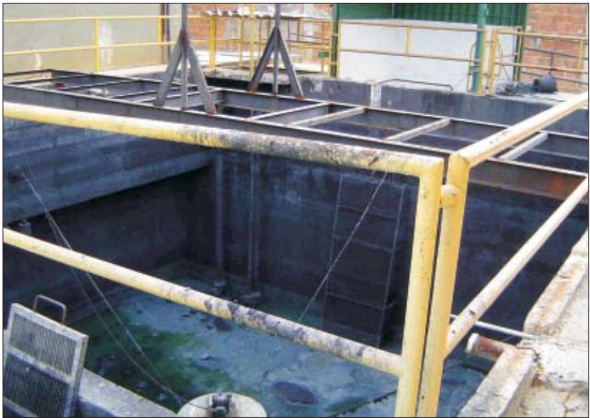
Foto 27 – Tanque de Equalização com Aerador do Tipo Turbina
