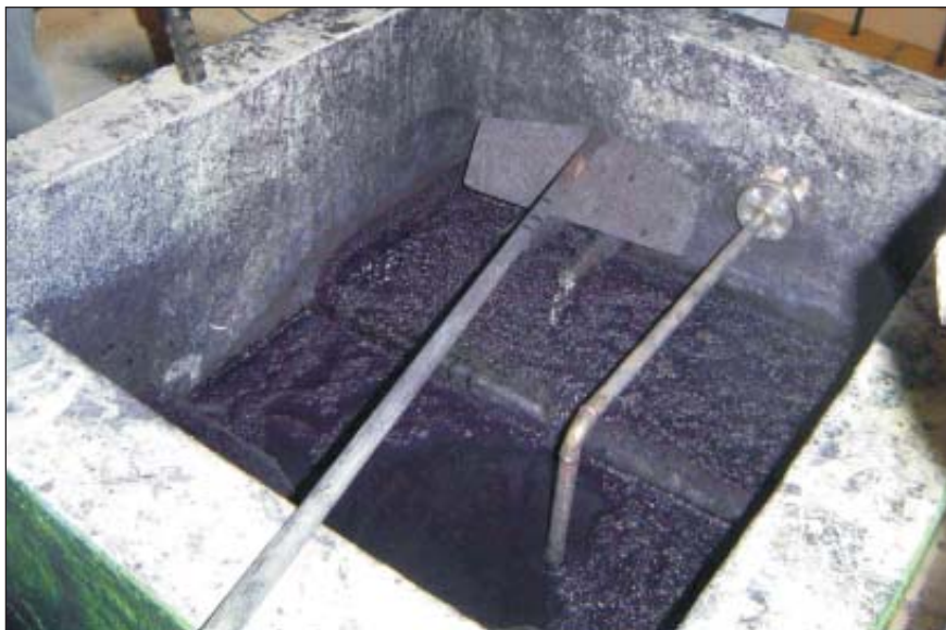
Foto 29 – Dosagem de Coagulantes e Auxiliares de Coagulação
