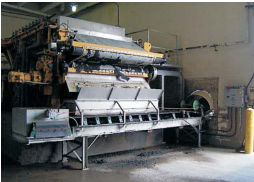
Foto 23 – Vista de uma Prensa Desaguadora Usada na Desidratação de Lodo Fonte: CWFTX
