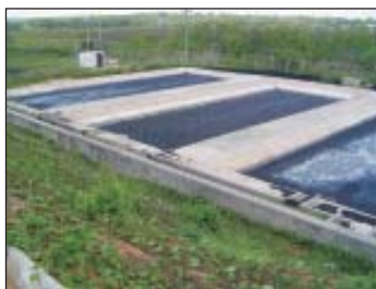
Foto 22 - Vista de uma Célula do Sistema de Leitos de Secagem
