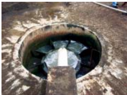
Foto 17 – Sistema de Distribuição do Afluente em um Reator Circular
