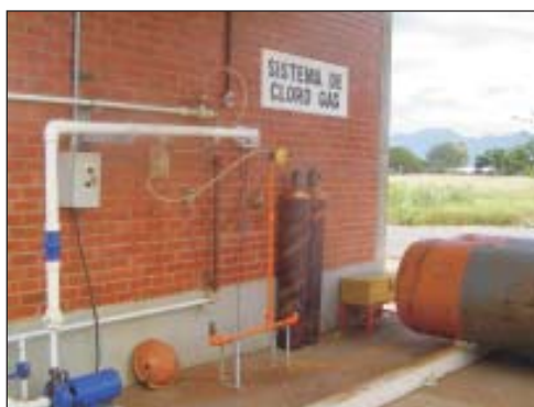
Foto 20 – Vista de um Sistema de Desinfecção por Cloração
