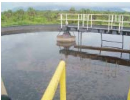
Foto 9 – Vista da Ponte Móvel de um Decantador Circular
