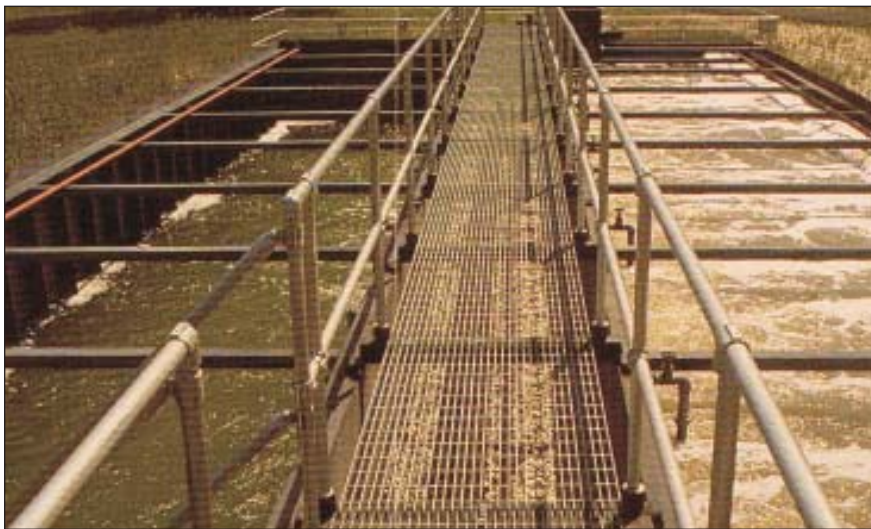
Foto 15 – Vista de um Reator de Lodos Ativos em Batelada
