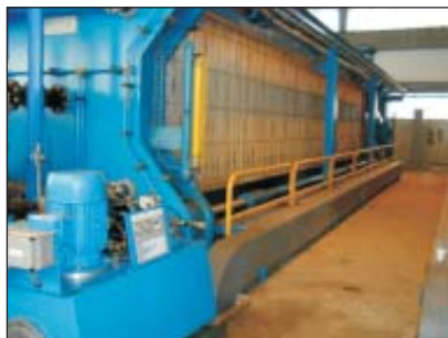
Foto 24 – Filtro-Prensa Utilizado no Tratamento de Lodo
