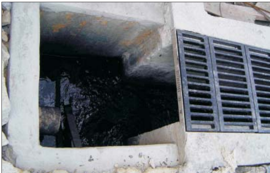
Foto 25 – Entrada do Esgoto Antes da Grade e Caixa de Aréia
