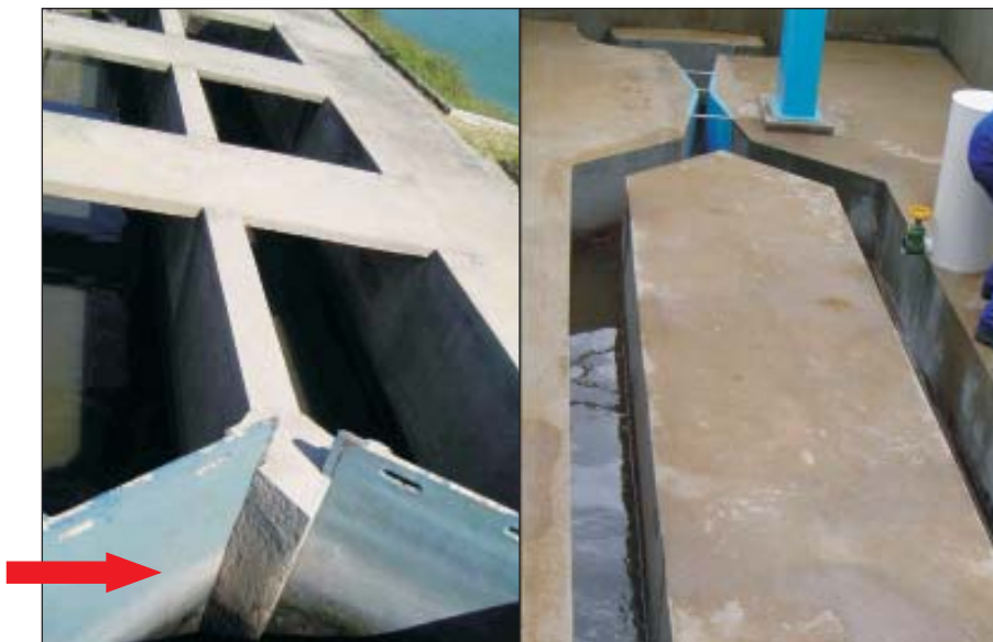
Foto 3 – Exemplo de Unidades de Desarenação, em que a Seta Indica os Stop-Logs Instalados para Controle do Fluxo
