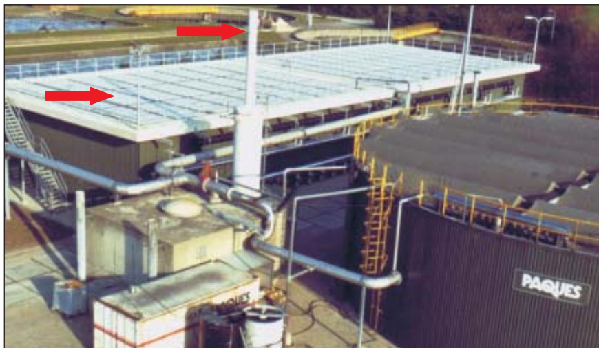
Foto 16 – Reator UASB e Sistema de Queima do Biogás
