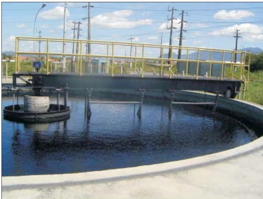
Foto 14 – Vista de um Decantador Secundário de um Sistema de Lodos Ativados
