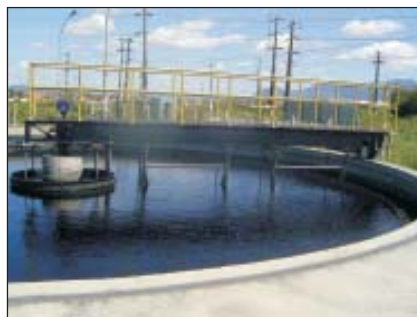
Foto 6 – Vista de um Decantador Primário
